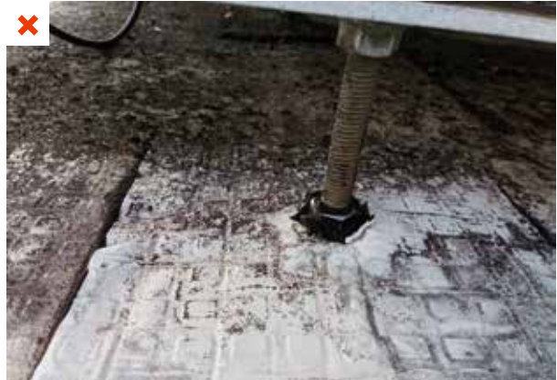
Défaut d'étanchéité au niveau de la fixation d'un panneau solaire. ©AQC
