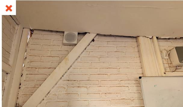
Altération du joint entre les BTC de remplissage et l'ossature porteuse en bois. ©AQC
