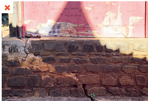
La rupture du soubassement en pierre menace la stabilité générale du mur. ©AQCC
