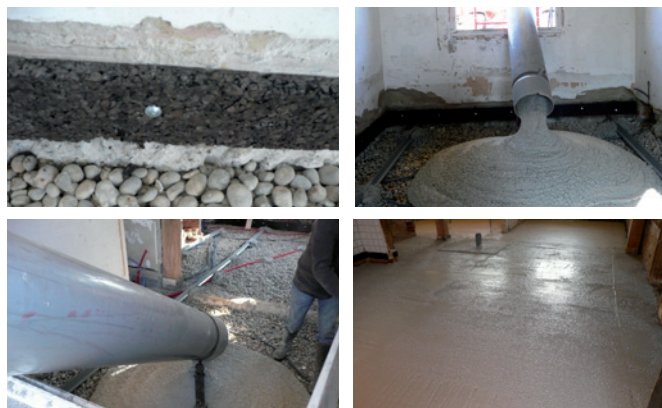
Photographies illustrant la mise en œuvre d'un béton de pierre ponce sur hérisson de cailloux, en réhabilitation, avec bande de désolidarisation isolante en liège en périphérie.
