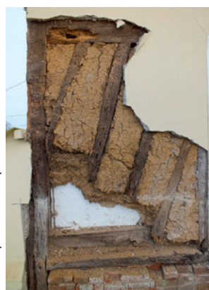
1) Un mur en pan de bois, victime d'un mauvais usage de matériaux contemporains (Polystyrène et enduit ciment)
