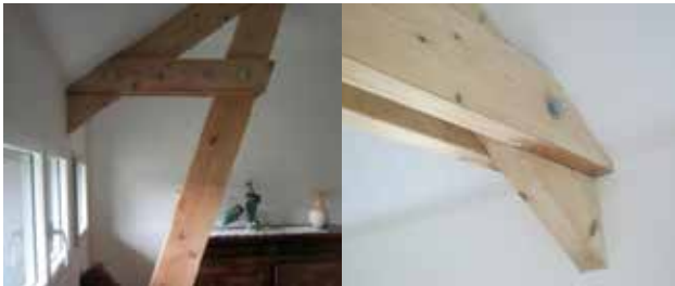
Fuite entre la charpente et le doublage : Le bois et le doublage sont deux éléments qui « travaillent » avec le temps. Cette fuite due au craquellement du joint s'intensifie d'autant plus avec le nombre d'éléments traversants.
