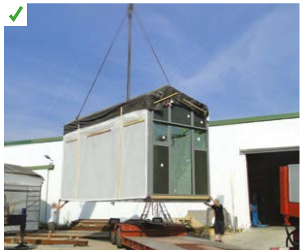
Chargement d'un module en sortie d'atelier. Les parois « ouvertes » sont bâchées pour éviter les déformations lors des opérations de levage et pendant le transport. ©AQC
