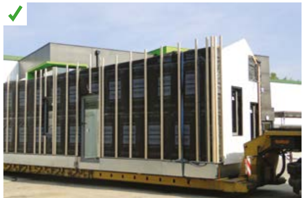
L'utilisation de remorques rabaissées permet de passer les ponts sans encombre. ©AQC
