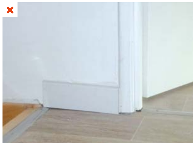
Différence de niveau entre deux modules visible sous la plinthe. ©FCBA
