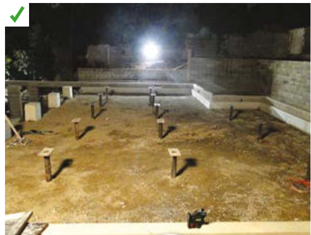
Sur ce chantier, la parcelle ne disposant d'aucune surface libre pour stocker les modules, ceux-ci ont été levés et posés directement à leur emplacement définitif. Les moyens de transport ont donc été bloqués le temps de la pose, ce qui avait été anticipé. ©AQC
