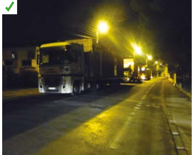
Pour ce chantier, la rue a été bloquée une nuit, le temps de livrer et de poser l'ensemble des modules. Les délais ont été tenus. ©AQC
