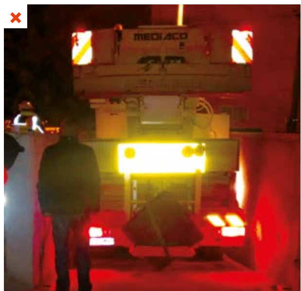
La grue de levage utilisée sur la parcelle ne passe le portail qu'à quelques centimètres près, risquant une dégradation du mur de mitoyenneté et pouvant poser un problème de sécurité. ©AQC
