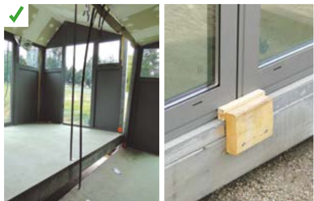
Gauche : les raidisseurs métalliques positionnés sur les parois « ouvertes » des modules empêchent le cintrage du module sous son propre poids. ©AQC Droite : des cales de bois empêchent l'ouverture intempestive des menuiseries. ©AQC
