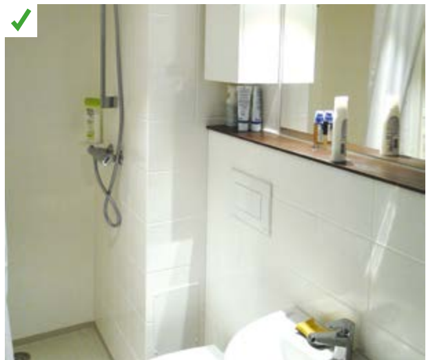
Sur cette opération, la salle de bains est livrée finie. Des trappes de raccords sont prévues pour l'intervention du plombier afin de ne pas abîmer les finitions. ©AQC
