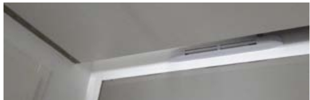
La tablette, ajoutée au-dessus de la porte à la demande du maître d'ouvrage après fabrication, entre en conflit avec la bouche d'entrée d'air du logement. ©AQC
