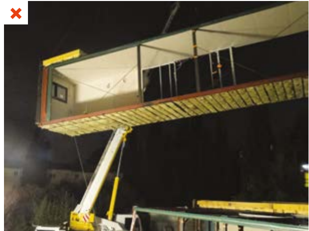
Isolant extérieur et revêtement intérieur ne sont pas protégés des risques de pluie lors de la pose du module sur chantier. ©AQC
