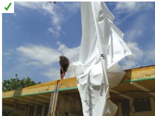
La bâche du module est retirée une fois le module posé et étanché. ©AQC
