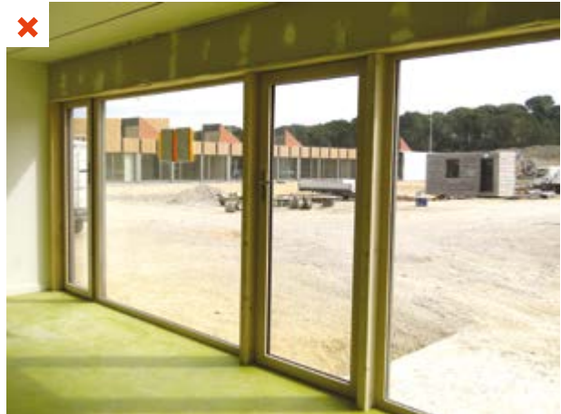
Sols intérieurs définitifs posés en atelier qui se salissent sur chantier tant que les travaux extérieurs ne sont pas terminés. ©AQC
