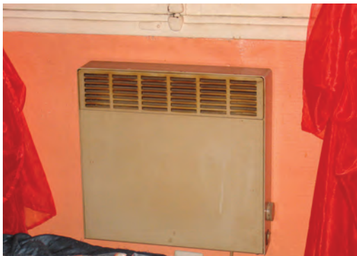
Convecteurs électriques souvent symboles de précarité énergétique
