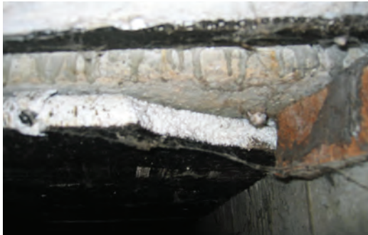
isolant dégradé en vide sanitaire
