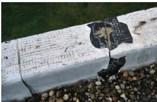
Toiture Acrotère non isolée n'assurant plus l'étanchéité
