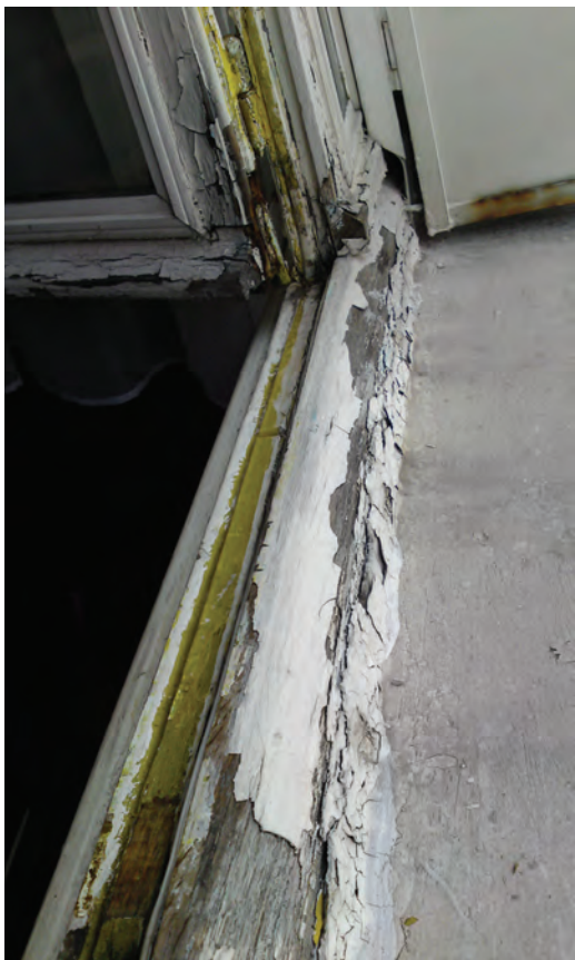
Baie bois à remplacer, ouvrant et dormant
