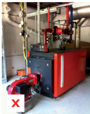
Chaudière surdimensionnée après rénovation thermique.
