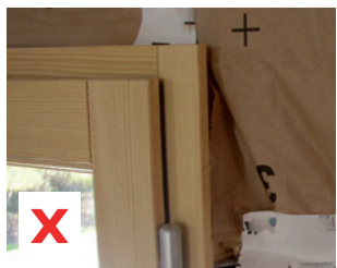
Discontinuité du plan d'étanchéité à l'air au niveau de la jonction entre le châssis (dormant) et la membrane d'étanchéité à l'air.
