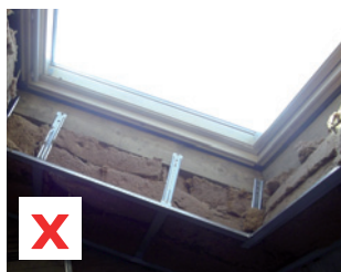
Absence de retour de la membrane sur le «tableau», jonction avec la menuiserie non assurée.
